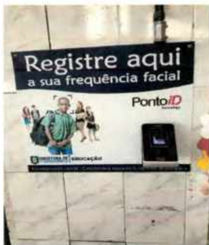
Controlador facial 01 (Depois da instalação)
