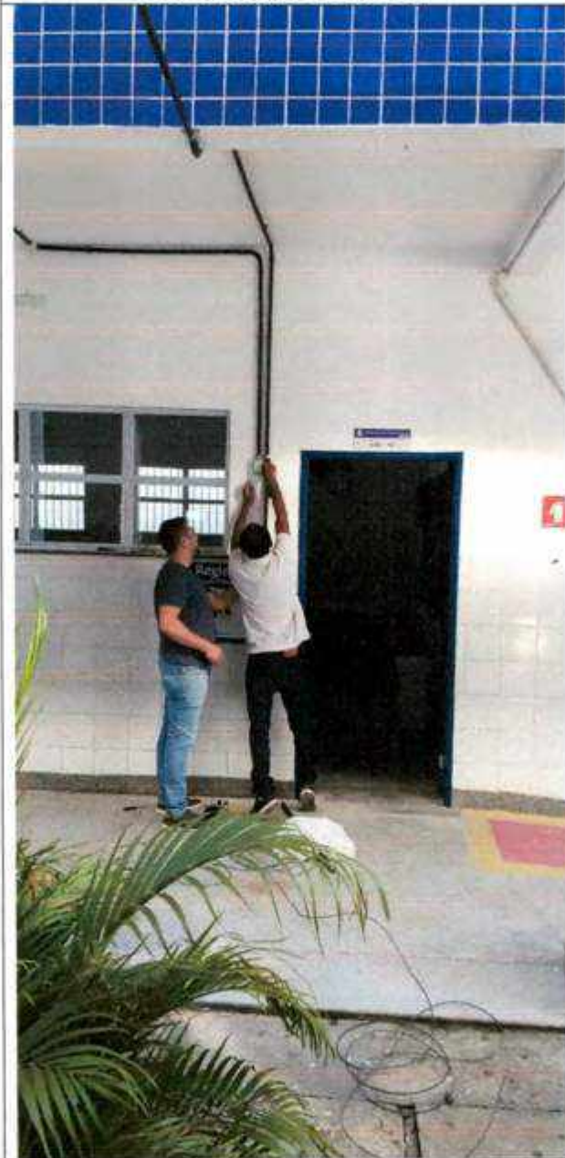
Instalado ao lado da sala 02
