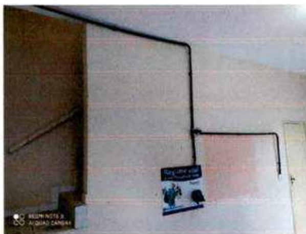
Controlador facial 01 (depois da instalação)
