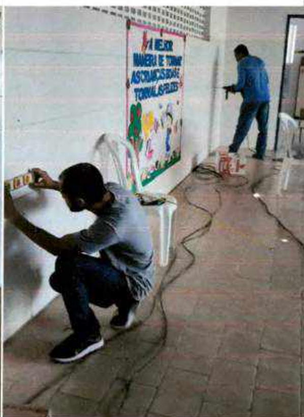
Instalado ao lado da sala de aula
