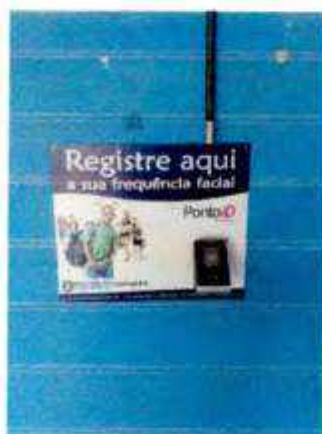
Controlador facial (01) Depois da instalação
