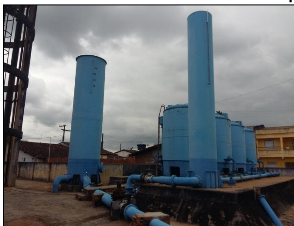
Figura 25: Filtro de areia e torres de alívio de pressão
