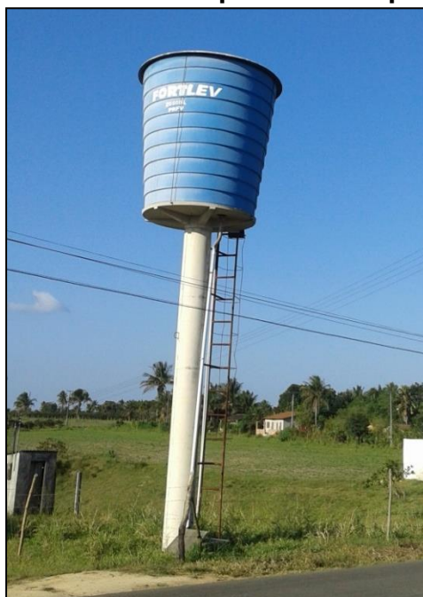
Figura 87: Reservatório no povoado Dispensa (poço 2)
