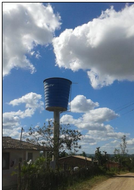
Figura 68: Reservatório do poço no povoado Rosário
