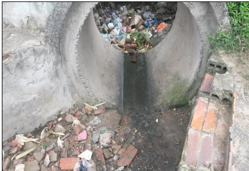
Figura 106: Ponto de contaminação E8
