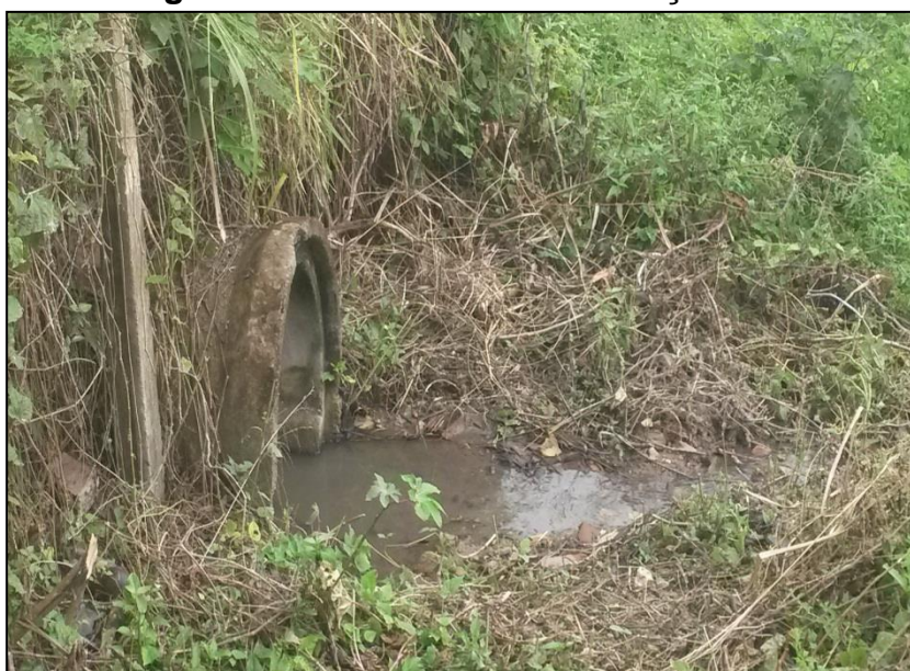
Figura 109: Ponto de contaminação E11
