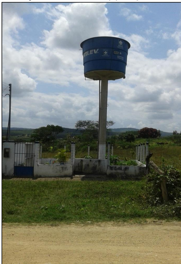
Figura 90: Poço e reservatório (2) no povoado Muquém
