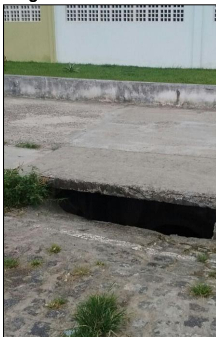
Figura 113: Boca de Lobo
