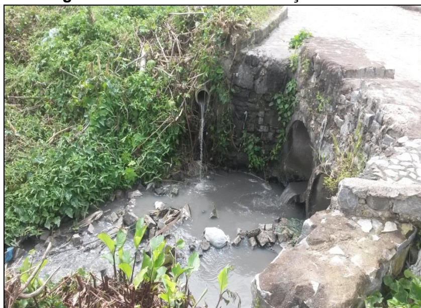
Figura 100: Ponto de contaminação E1
