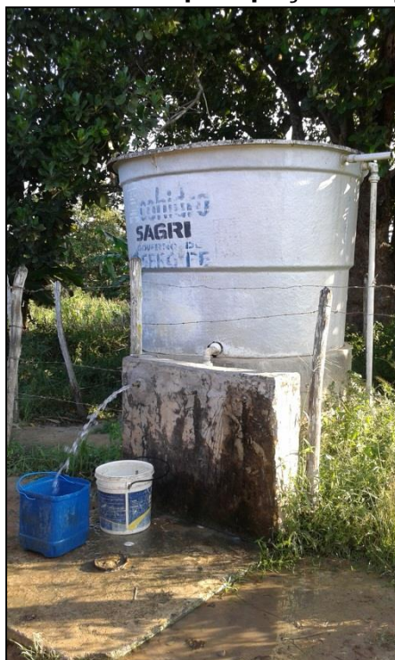
Figura 86: Chafariz abastecido pelo poço 1 no povoado Dispensa
