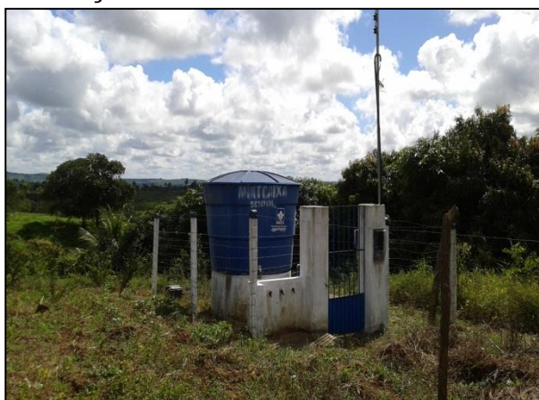
Figura 34: Poço e reservatório no Povoado Diamantes
