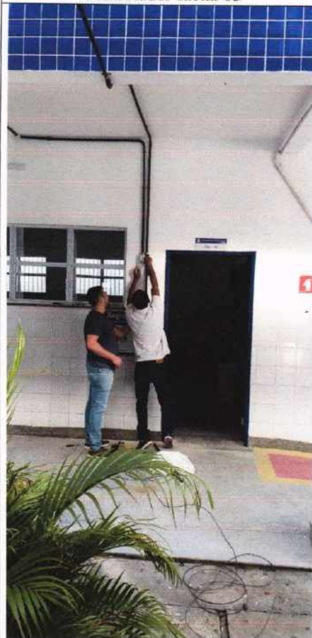
Instalado ao lado da sala 02
