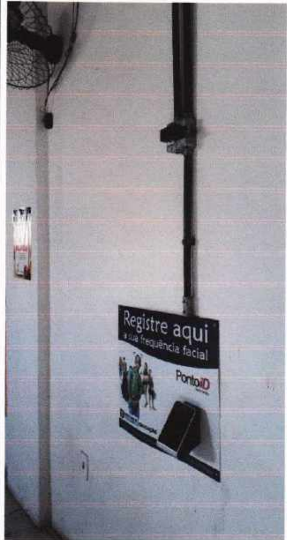
Instalado no anexo da Escola Mun. Oséas Cavalcanti Batista
