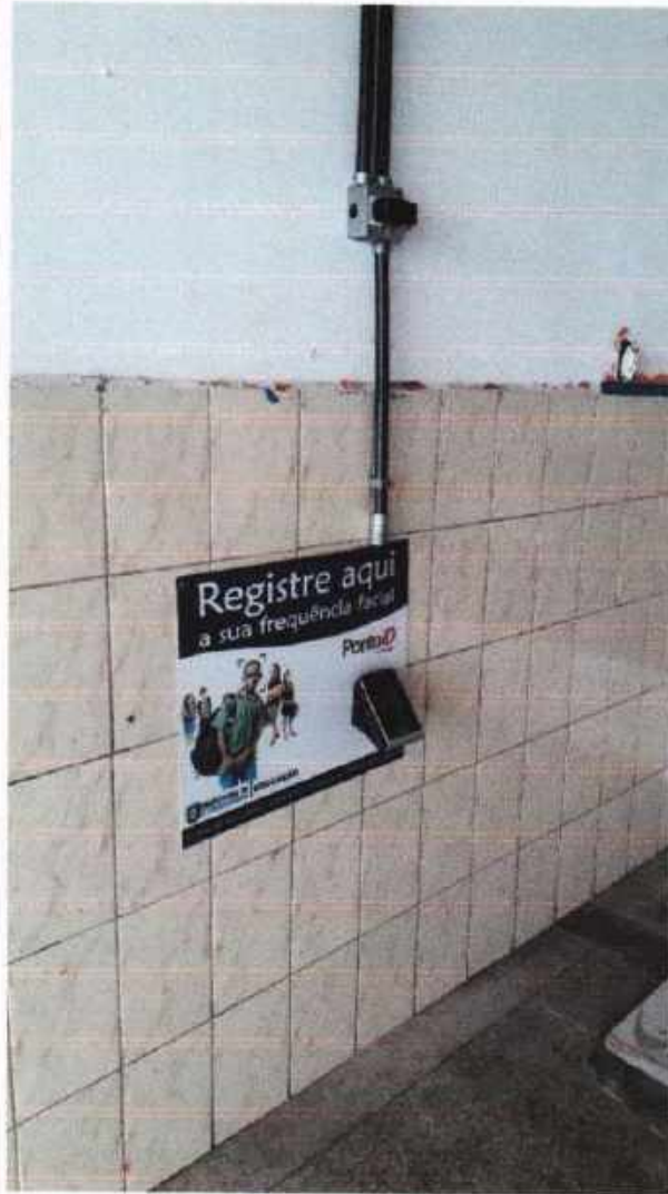
Instalado na área do pátio escolar
